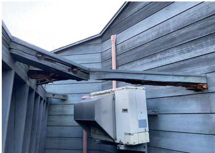
【エアコン室外機 の囲い】
