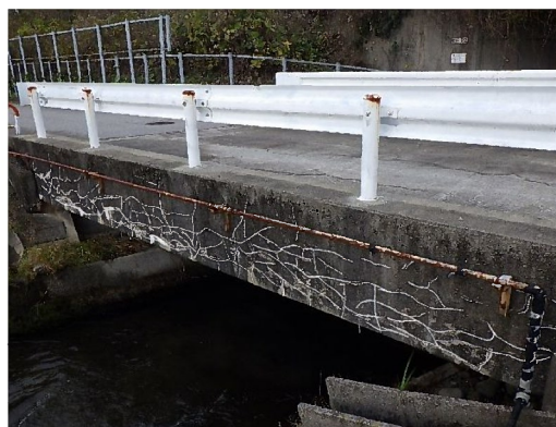
名無し橋422 路面：地覆 コンクリート：剥離・剥落
