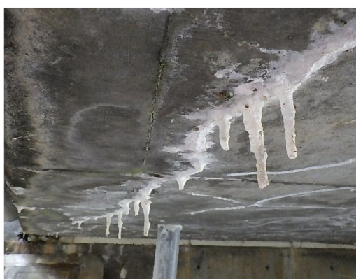
名無し橋422 上部工：庄版 コンクリート：漏水・遊離石灰
