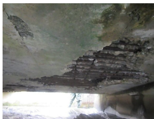
名無し橋4 上部工：庄版 コンクリート：剥離・鉄筋露出
