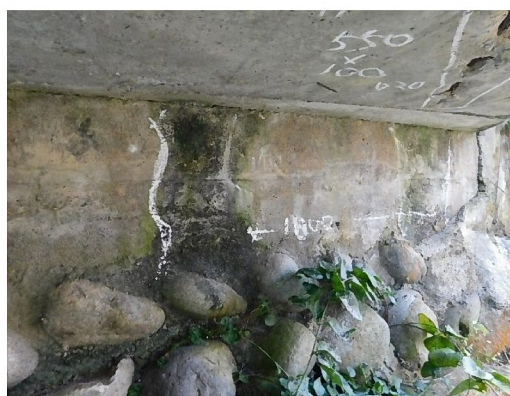
名無し橋17 下部工・躯体 コンクリート：ひびわれ
