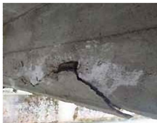
名無し橋353 上部工：主構 コンクリート：ひびわれ
