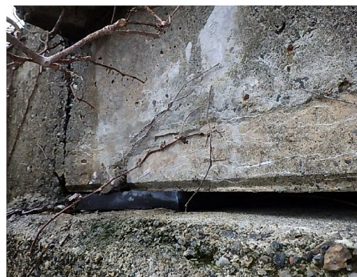
名無し橋427 支承部・支承体 支障体の腐食等
