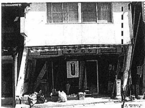
写真③-1 (傾き 3.8/20) [出典※1] (ランク 4)
