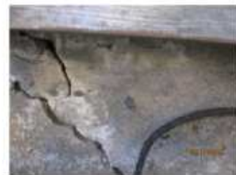
現状基礎ひび割れ 地盤の締固め状況が良くない
