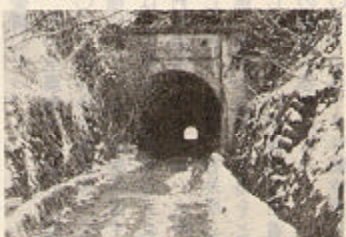
改修のぞまれる熊坂ずい道
