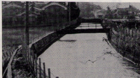
改修が待たれる黒東合口用水(新屋地内)
