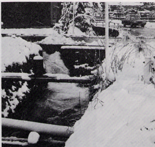
▲ サイ水で改良が望まれる舟見5号排水路
