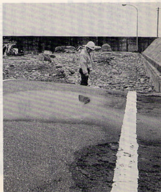
▲被害を受けた漁港管理道路
