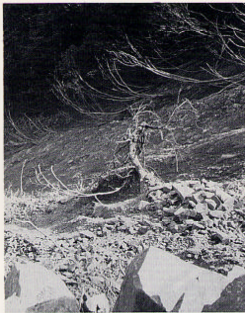
▲崩壊した林道六谷線
