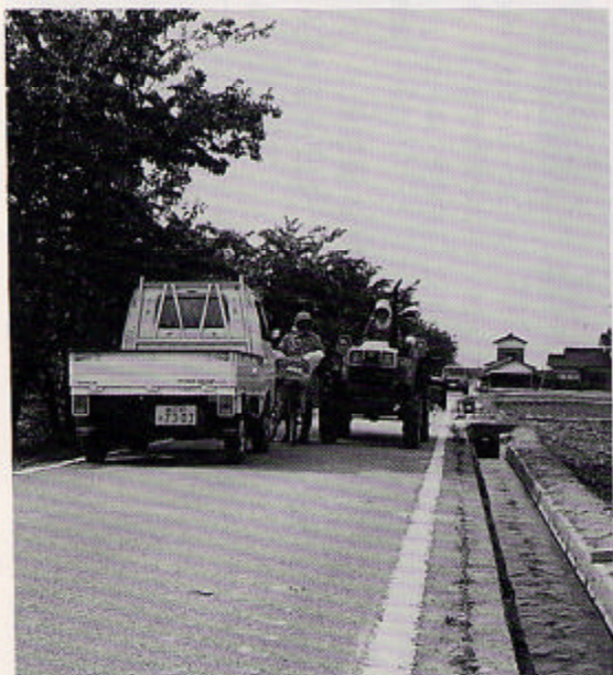
▲狭い農道の整備を(櫛山地内)
