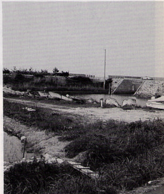
▲改修が望まれる入川河口の舟溜り
