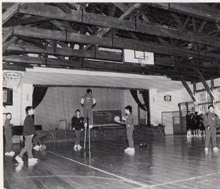
▲老朽化した舟見小学校講堂
