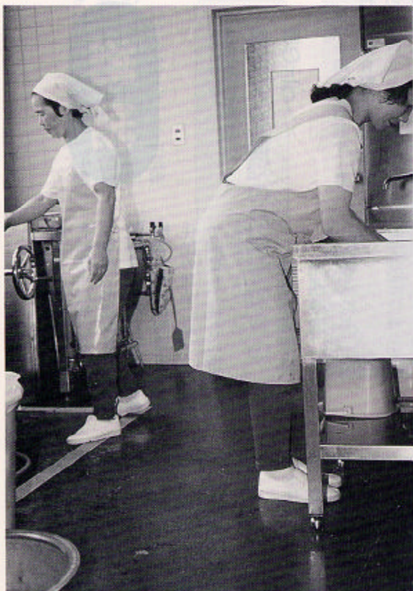
▲ 補修を待つ、飯野保育所調理室の床
