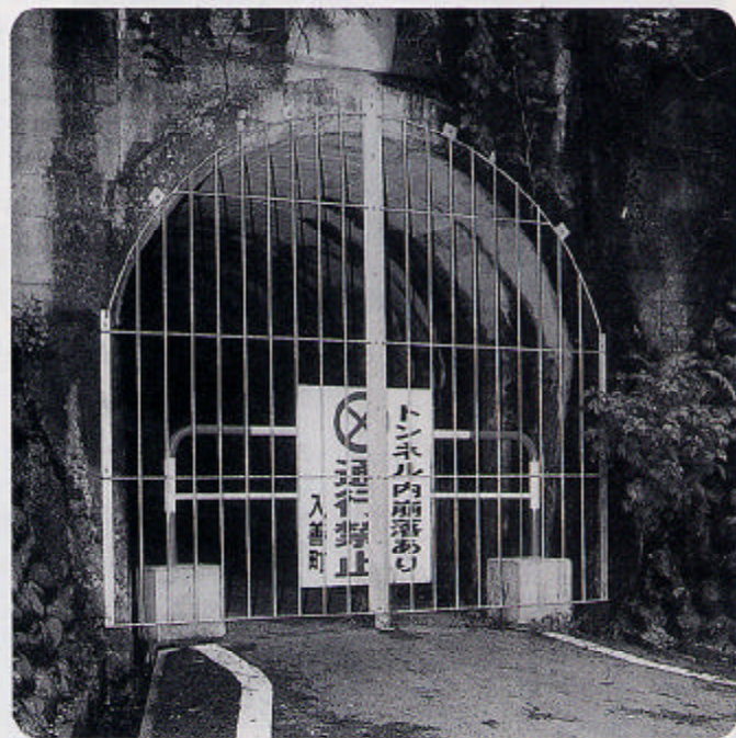
再開用途のたたない熊坂トンネル
