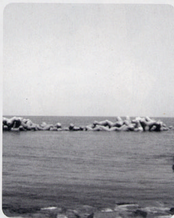
復旧が待たれる離岸堤
