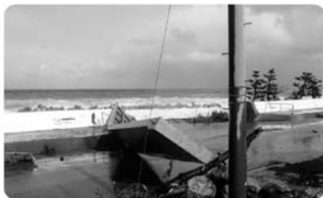
破壊された防潮屏
