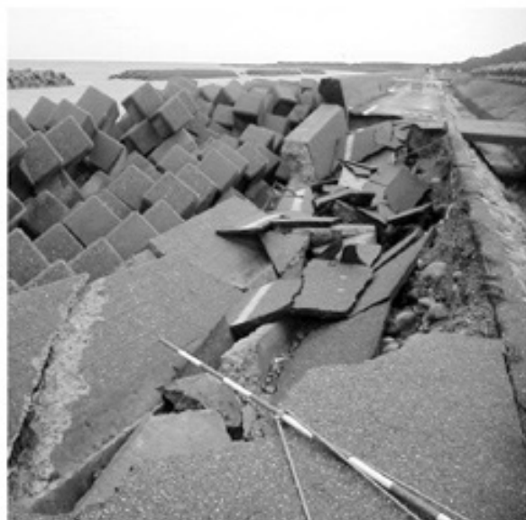
倒壊した護岸(神子沢地区)
