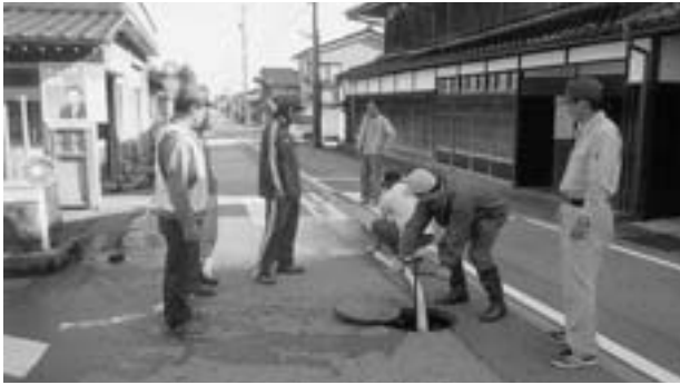
自主防災会で消火栓の点検(舟見地内)
