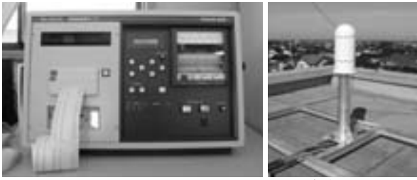
入善地内に設置されたモニタリングポスト (新川土木センター入善土木事務所屋上)
