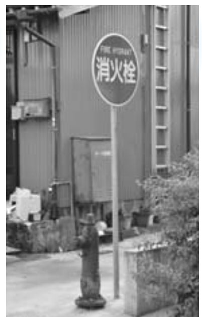
消火栓の標識
