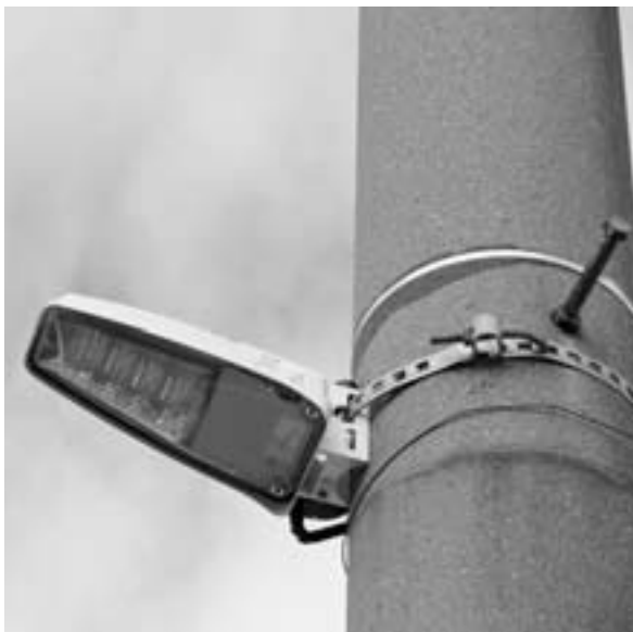
LED化された防犯灯
