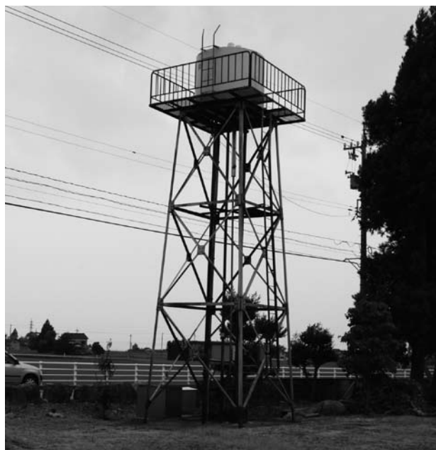
老朽化した簡易水道施設（野中地内）
