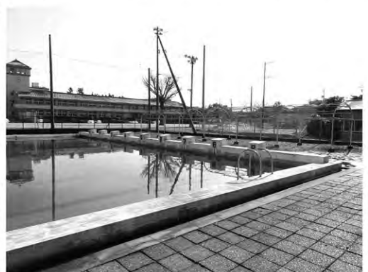
老朽化した中央プール
