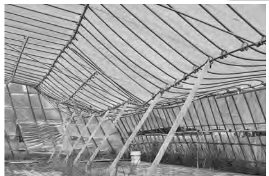
強風被害にあった農業ハウス
