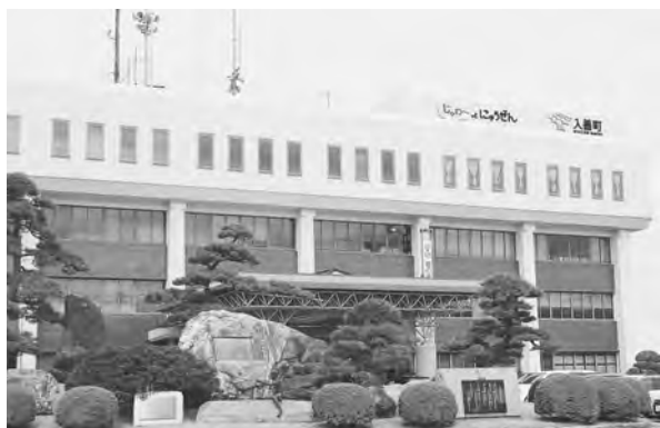
老朽化した役場庁舎 耐震化が建て替えか
