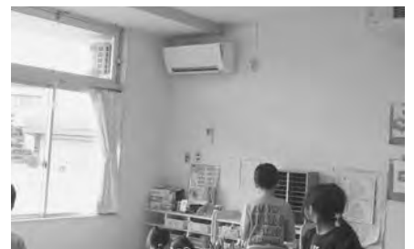
保育室に設置されているエアコン
