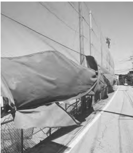
破損した防砂ネット
