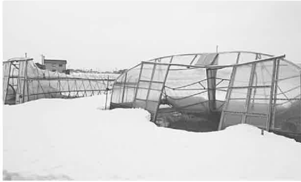
雪で倒壊した農業用ハウス
