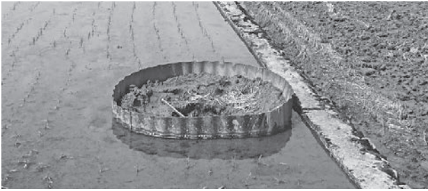
田の陥没復旧を予算化
