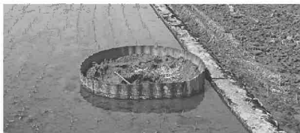
田の陥没復旧を予算化
