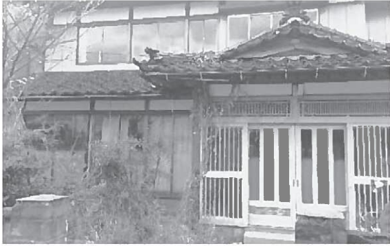
危険な老朽空き家
