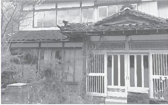
危険な老朽空き家
