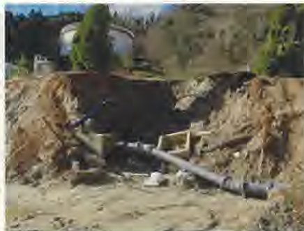
浄水場内の配管損傷 (七尾市)
