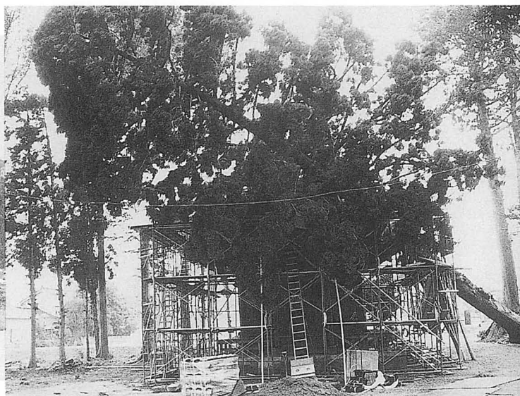
▲改修工事中だった野中天照神社が倒木により半壊。工事はやり直しとなった。
