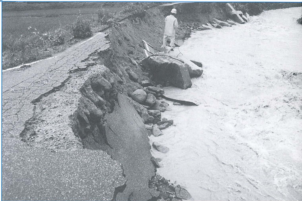
▲濁流が道路を削り取った(舟見地区、舟川バーデン明日上流)
