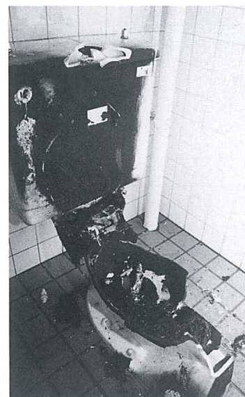
▲園家山の公衆トイレ被害
