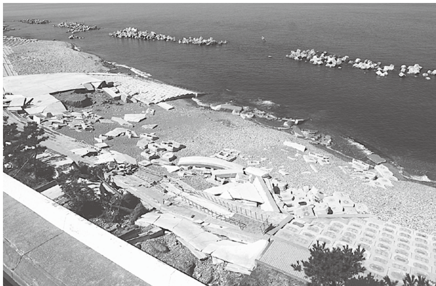
▲高波により破壊された護岸施設。さわやか海岸の面影は、跡形もなく。
