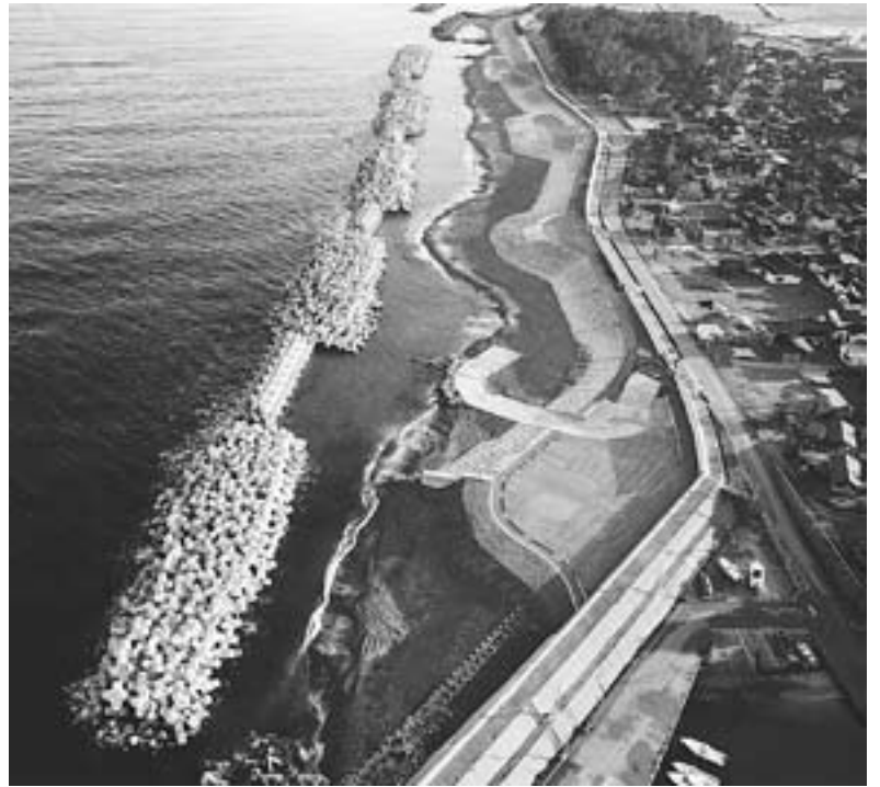
▲復旧作業が完了した入善漁港海岸。現在、第2堤防の建設が進められています
