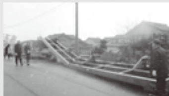
重さ約4トンの防波扉は破壊された
