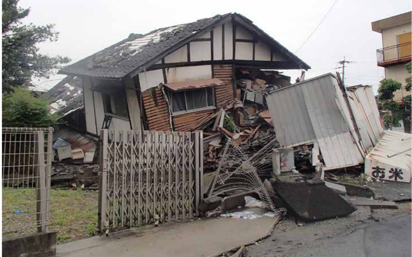
▲熊本地震で倒壊した住宅(富山県土木部建築住宅課 提供)
