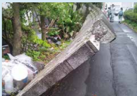
◀地震で倒壊したブロック塀(提供元は上記写真に同じ)
