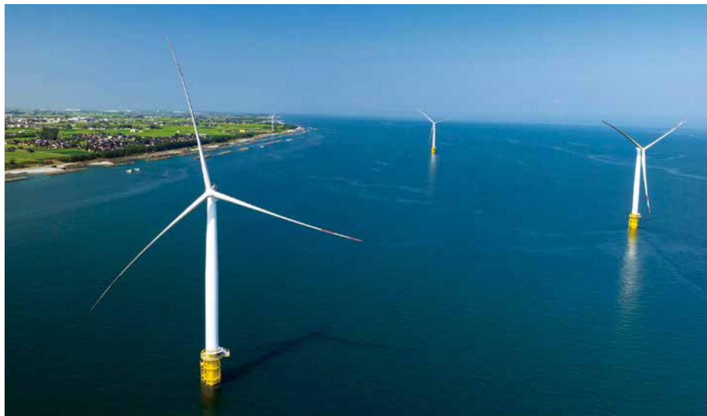
▲上空から撮影した洋上風力発電施設
