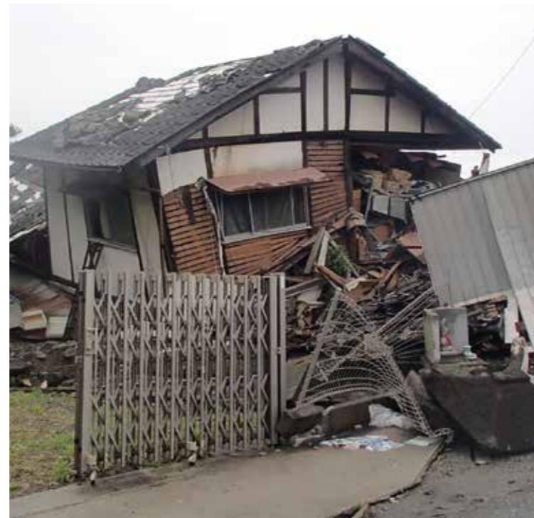
▲熊本地震で倒壊した住宅(富山県土木部建築住宅課 提供)
